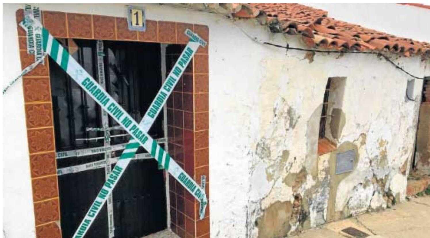
La Benemérita ya ha vuelto a colocar el precinto para preservar la seguridad del inmueble.
